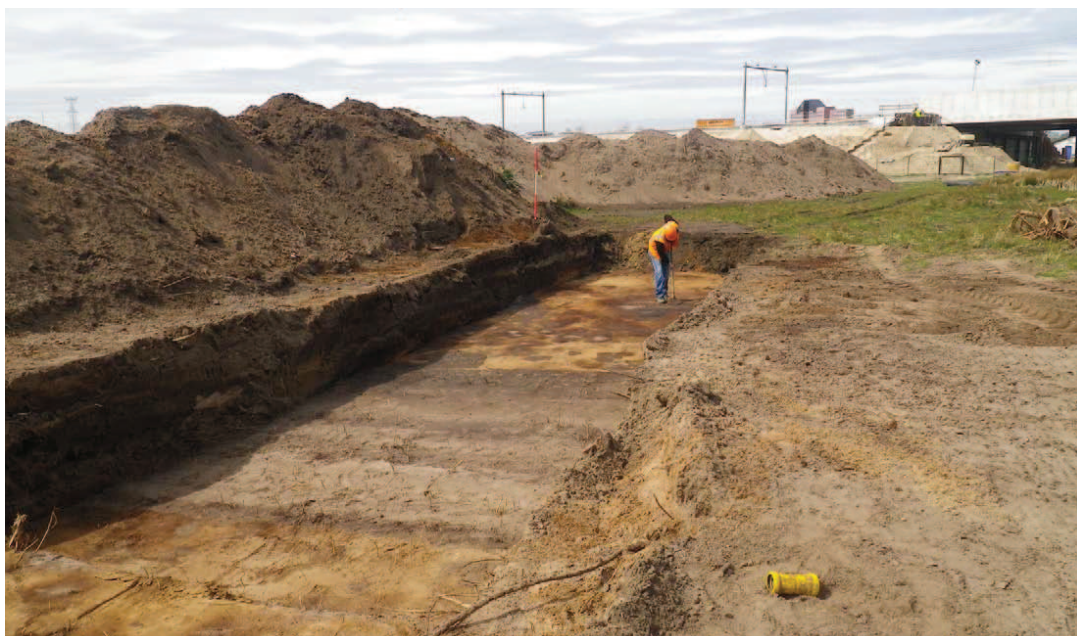
Afb. 3.10 Handmatig opschaven van het vlak op de Burg. Jhr. Von Heijdenlaan. (Foto richting noordwest).
