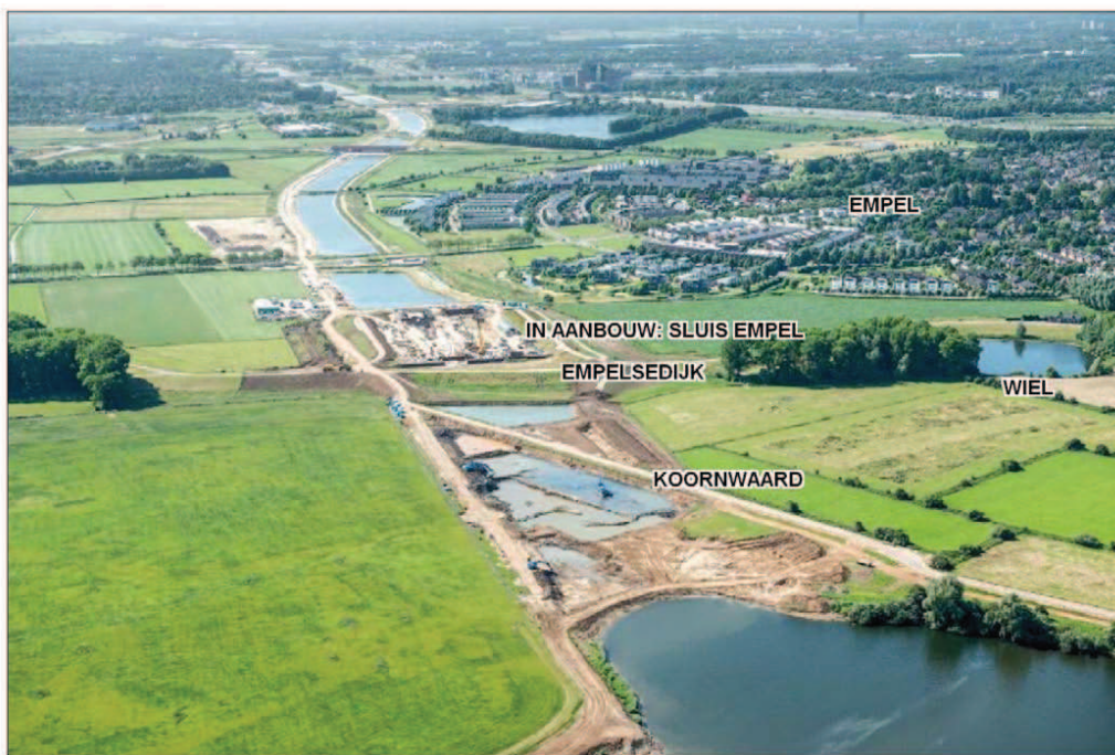
Afb. 2.15 Luchtfoto van de Koornwaard en Empelsedijk ten tijde van de sanering van de Koornwaard en de in aanbouw zijnde sluis Empel (foto Rijkswaterstaat).
